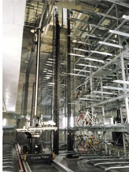
立体機械式駐輪場はセキュリティ、利便性、省スペース、景観保持に優れた駐輪システムだ(写真はJFEエンジニアリングが東京の大手町フィナンシャルシティグランキューブの地下に整備したサイクルツリーの内部)
